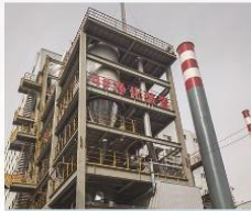
内蒙古君正81000KVA密闭电石炉炉气净化回收系统
